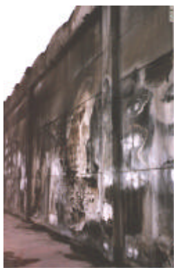
Figura 1: Capannone danneggiato in Prato
