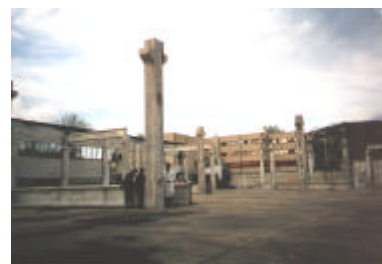
Figura 3: Rilievo in situ del danno – Prato
