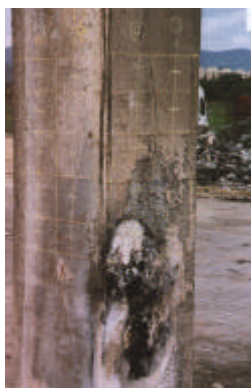
Figura 2: Pilastro in c.a. Danneggiato dal fuoco – Prato
