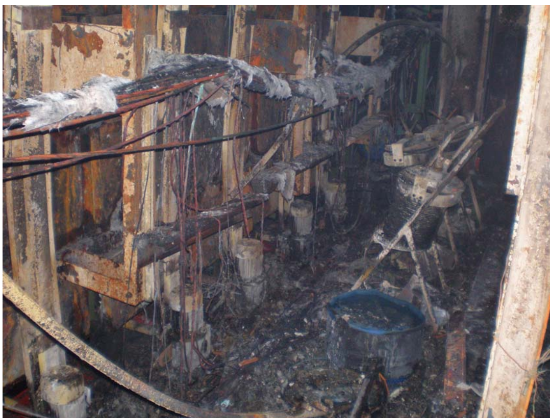
Figura 2 Particolare dell'incendio linea 2004 con coinvolgimento apparecchiature
