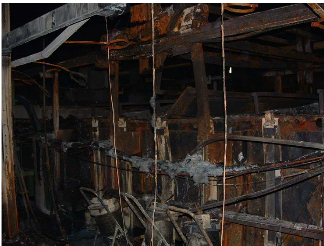
Figura 4 Incendio delle vasche della lavorazione nichel chimico
