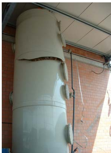
Foto n. 4. Colonna precedentemente utilizzata per il trattamento effluenti.
