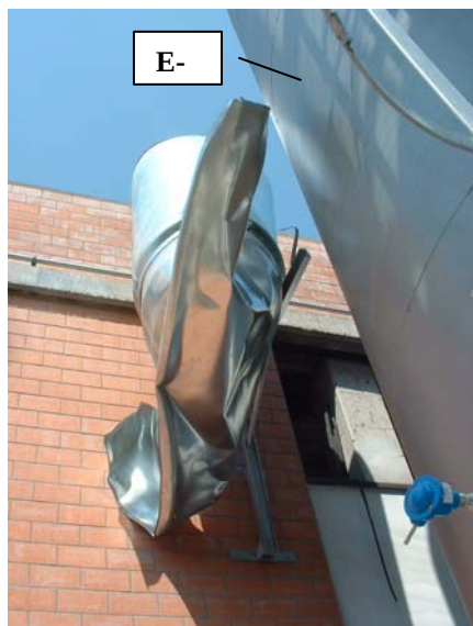
Foto n. 7. Ancora in sequenza, si nota, la deformazione del lamierino di alluminio impigliato intorno all'appoggio.
