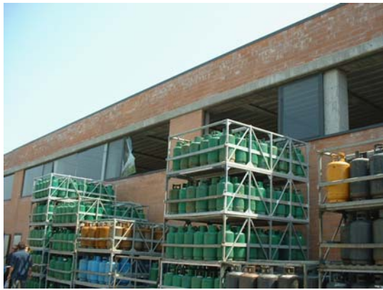
Foto n. 14. Vista dei danni agli infissi nel fabbricato n.14 to antistante l'impianto di termocombustione. capannone sul-
