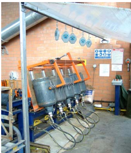
Foto n. 20. Nuova unità per il trasferimento della fase liquida e depressurizzazione dei bidoni.
