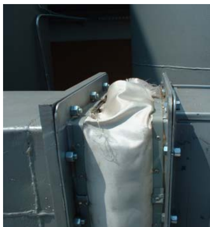
Foto n.11. Dettaglio giunto antivibrante.
