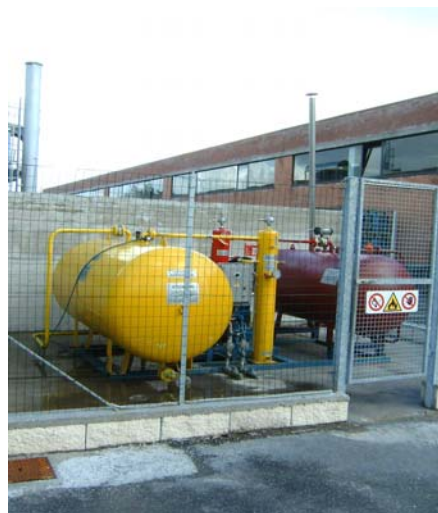
Foto n. 21. Serbatoi di accumulo e compressore di aspirazione del gpl contenuto nei bidoni.
