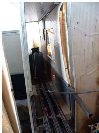
Foto n.2. Rulliera per il trasporto bidoni. Si noti la deformazione del pannello.
