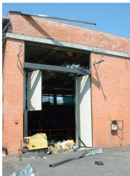
Foto n. 6. Proseguendo nel percorso della tubazione, si nota la completa distruzione della stessa ed il danno al portone.
