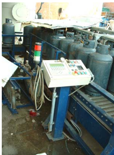
Foto n. 1. Posto operatore con il pannello di comando nella zona di bonifica.
