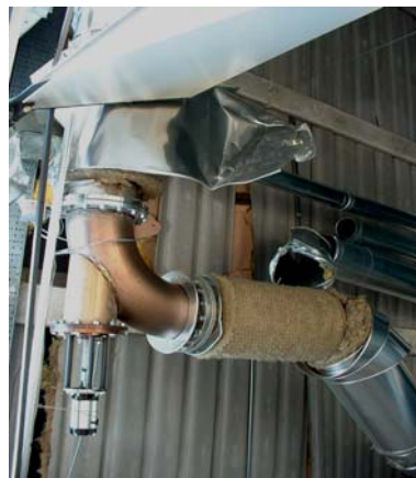
Foto n. 19. Valvola AV-6 di regolazione del flusso di fumi caldi alimentati al forno di essiccazione.
