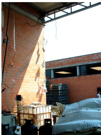
Foto n. 5. Si noti, in prossimità dello spigolo della parete, lo spezzone residuo della tubazione esplosa (zona bonifica bidoni sotto tettoia).
