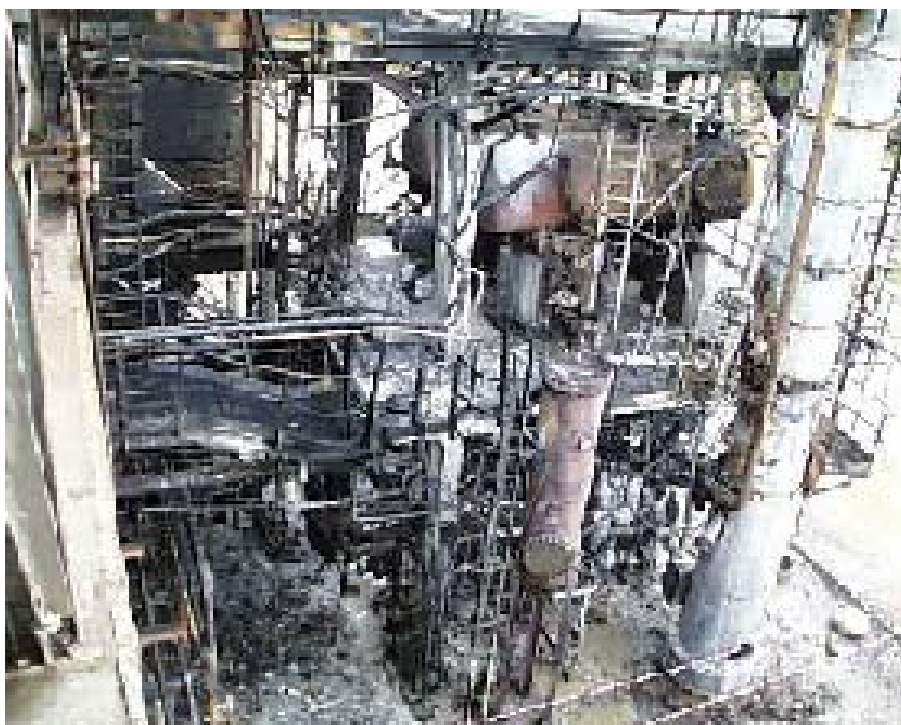
fig. 3 – danni all'unità saturazione benzene
